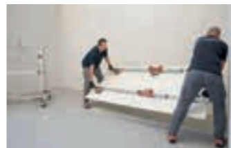
IT 5_ Mediante il telaio di movimentazione con ventose di sicurezza accompagnare la lastra in posizione e posarla.
